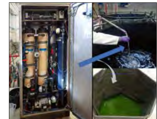
Abb. 4: Regenerative Anlage beim Versuch mit organischem Testwasser mit klarem Filtrat und Rückspülbecken
