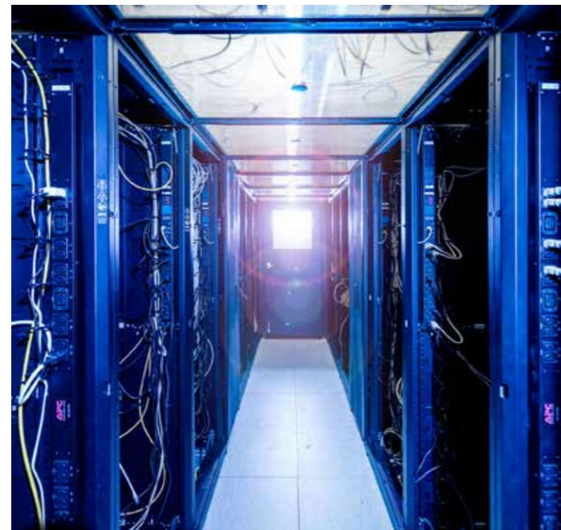
Blick in einen Serverraum der Hochschule Würzburg-Schweinfurt (Foto: FHWS)
