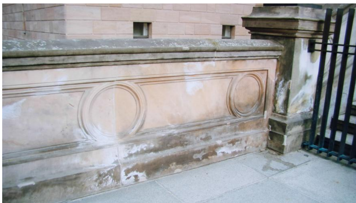
Abb. 3: Salzausblühungen 2014 an Bauteil C
