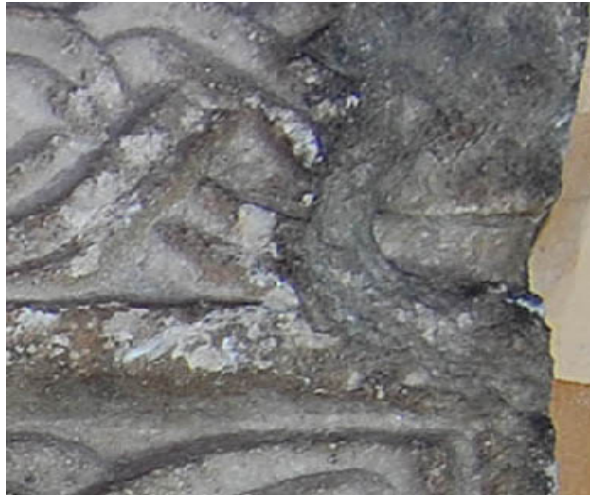
Abbildung 15: An diesem Dübelloch findet sich ein Ausbruch. Dieser ist vermutlich beim Abbruch der ursprünglichen Konstruktion durch Auseinanderhebeln der Verbindung am Dübel entstanden. Inventarnummer: M89/10'662, Bauteil: Mo 2b oder Mo 1b.
