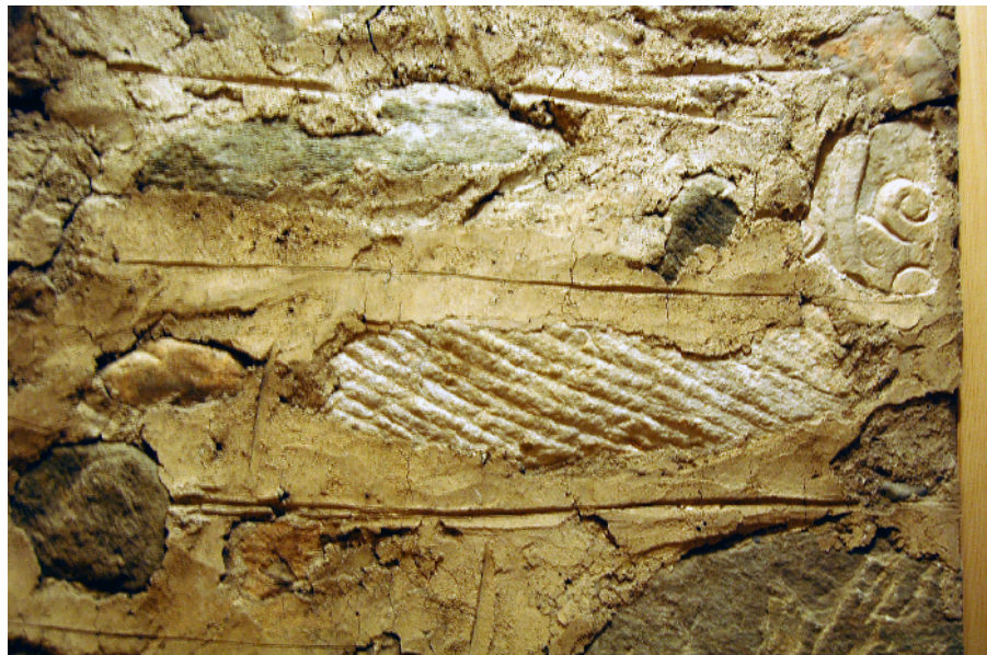
Abbildung 7: Ungeborgene Flechtwerksteine im romanischen Mauerwerk.
