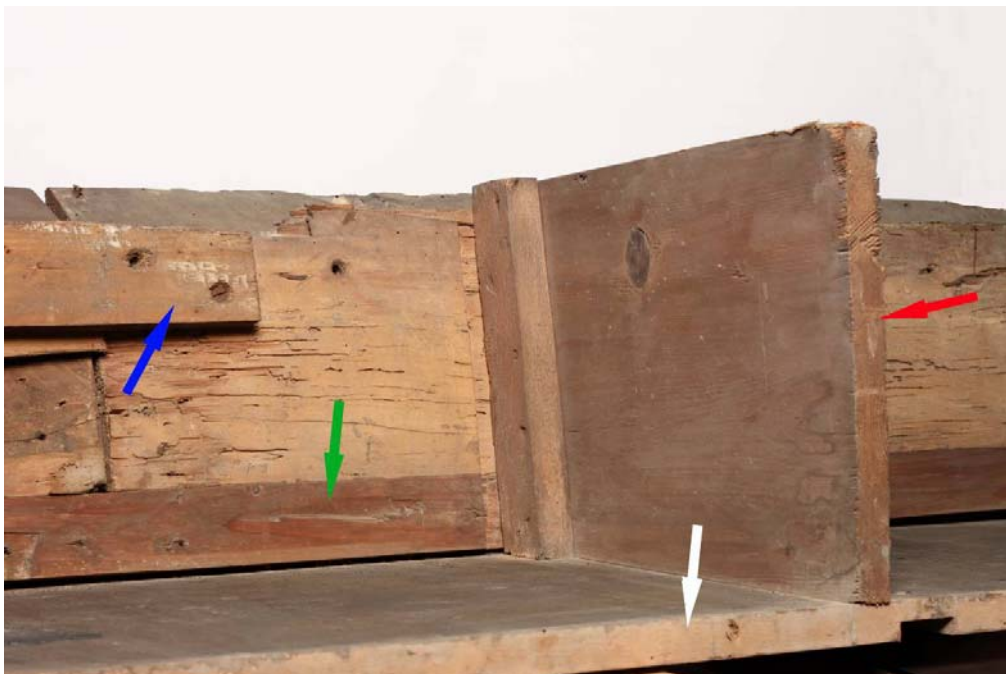
Abb. 63, Innenansicht des Gesimses, Ergänzungen aus dem 19. Jahrhundert - Aufdopplung zur Verbindung von Gesimsteilen (blau), eingefärbte Holzergänzung aus Fichte am Frontbrett (grün), eingefärbte Stützkonstruktion aus Fichte (rot), ergänztes Bodenbrett aus eingefärbtem Nussbaum (weiß)
