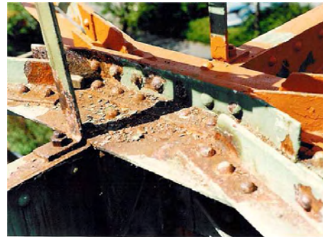
Abb. 20 Detailansicht eines Knotenpunktes: Ausfleckung der Fehlstellen. Foto: Dipl.-Ing. Mathias Conrads.
