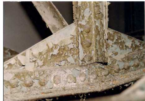
Abb. 25 Altbeschichtung an einem Knotenpunkt der Konstruktion vor der Bearbeitung. Foto: Dipl.-Chem. & Freischaffender Restaurator Wolfgang Conrad.
