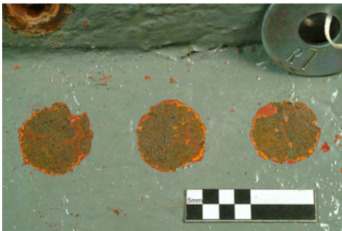
Abb. 37 Detailansicht nach dem Stempelabriss (Traufanker R7). Fehlende Haftung innerhalb und zwischen den unteren Schichten C bis F.
