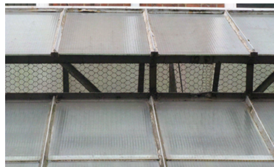
Abb. 7 Das Lüftungsgitter des Oberlichtes. Die mit Kittmasse verfüllten Fugen zwischen Glas und Glasleisten, so genannte Kittfasen. 60 Foto: Stefan Lasch-Abendroth.
