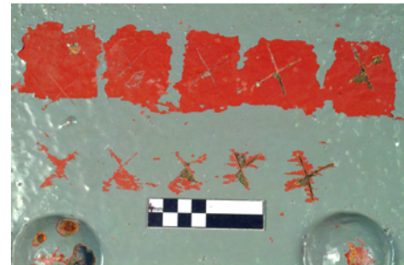
Abb. 42 Kreuzschnittprüfung auf der Fläche des Traufankers GR5. Untere Hälfte: Feld 1 bis 5 von links nach rechts, obere Hälfte: Kompressen-Test in gleicher Anordnung der Prüffelder. 202
