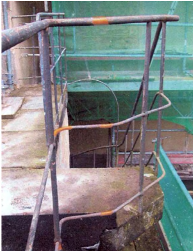
Abb. 14 Teilansicht des Geländers auf der Pergolawehrmauer. Grundierung mit Bleimennige an Trenn- bzw. Schweißstellen. Foto: Dipl.-Chem. & Freischaffender Restaurator Wolfgang Conrad.
