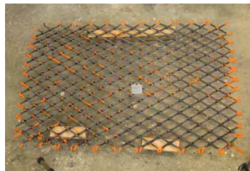
Abb. 23 Partieller Korrosionsschutz mit Bleimennige auf der Gitterfüllung. Foto: Dipl.-Rest. Christian Bode.
