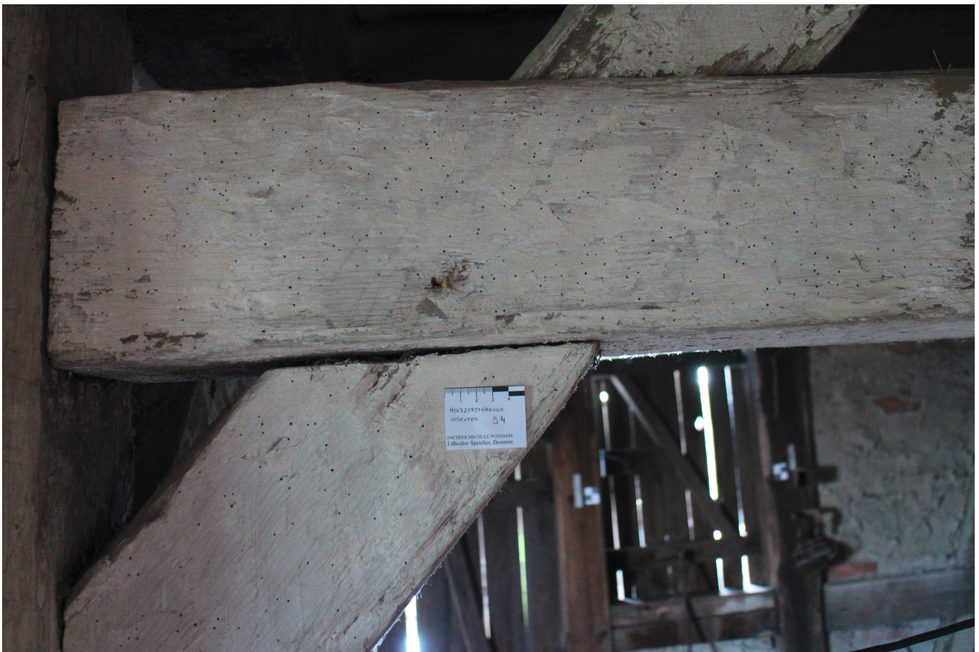
Abb.49 Holzschädigende Insekten (S4)
