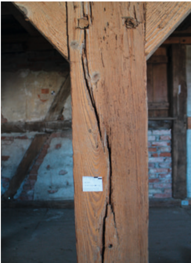
Abb.44 Risse (Mitte, West 10)
