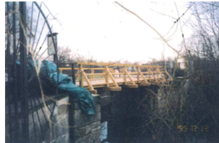
Abb. 39 Fertiggestellte Brücken- konstruktion. (aus: Protokoll über die Brückenarbeiten der Fa. Meyer, Fotodokumen- tation/SPSG).
