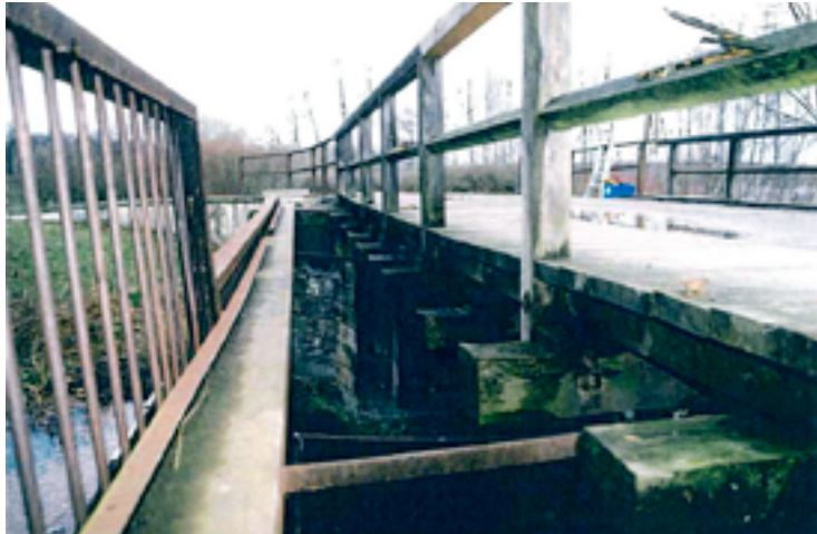
Abb. 34 Geländer mit geschädigter Knieleiste. (aus: Bestandsaufnahme 1989/1990, Fotodokumen- tation/SPSG).
