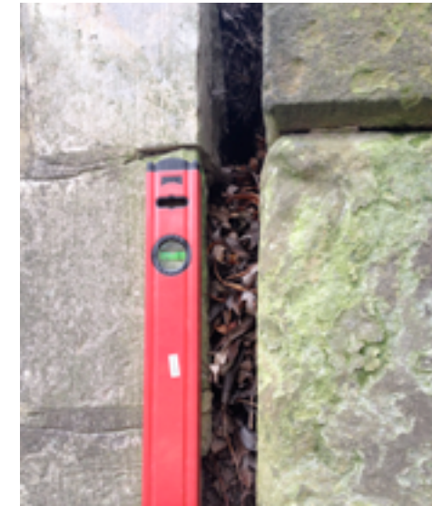
Abb. 43 Rissbildung am Brückenkopf. Foto: Drexler, Schäpel 2015.
