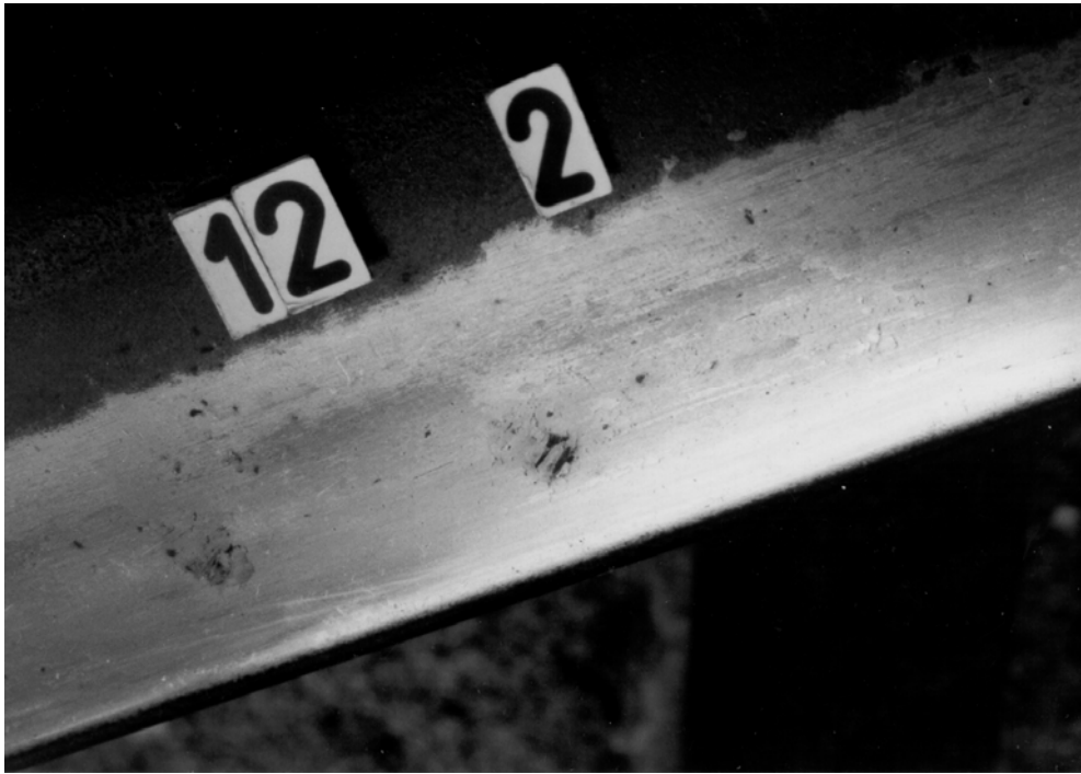
Bild 3: Periodische Fahrkantenschäden „Belgrospi“ mit Riffel.
