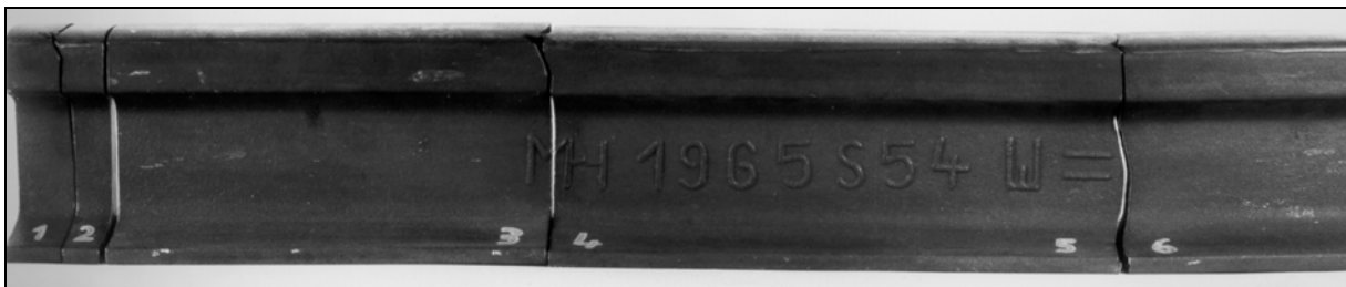
Bild 1: Seitenansicht einer durch Head Checks dreifach gebrochenen Eisenbahnschiene
