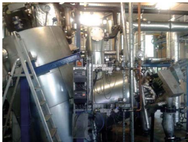
Abbildung 1: Foto der halbtechnischen Anlage
