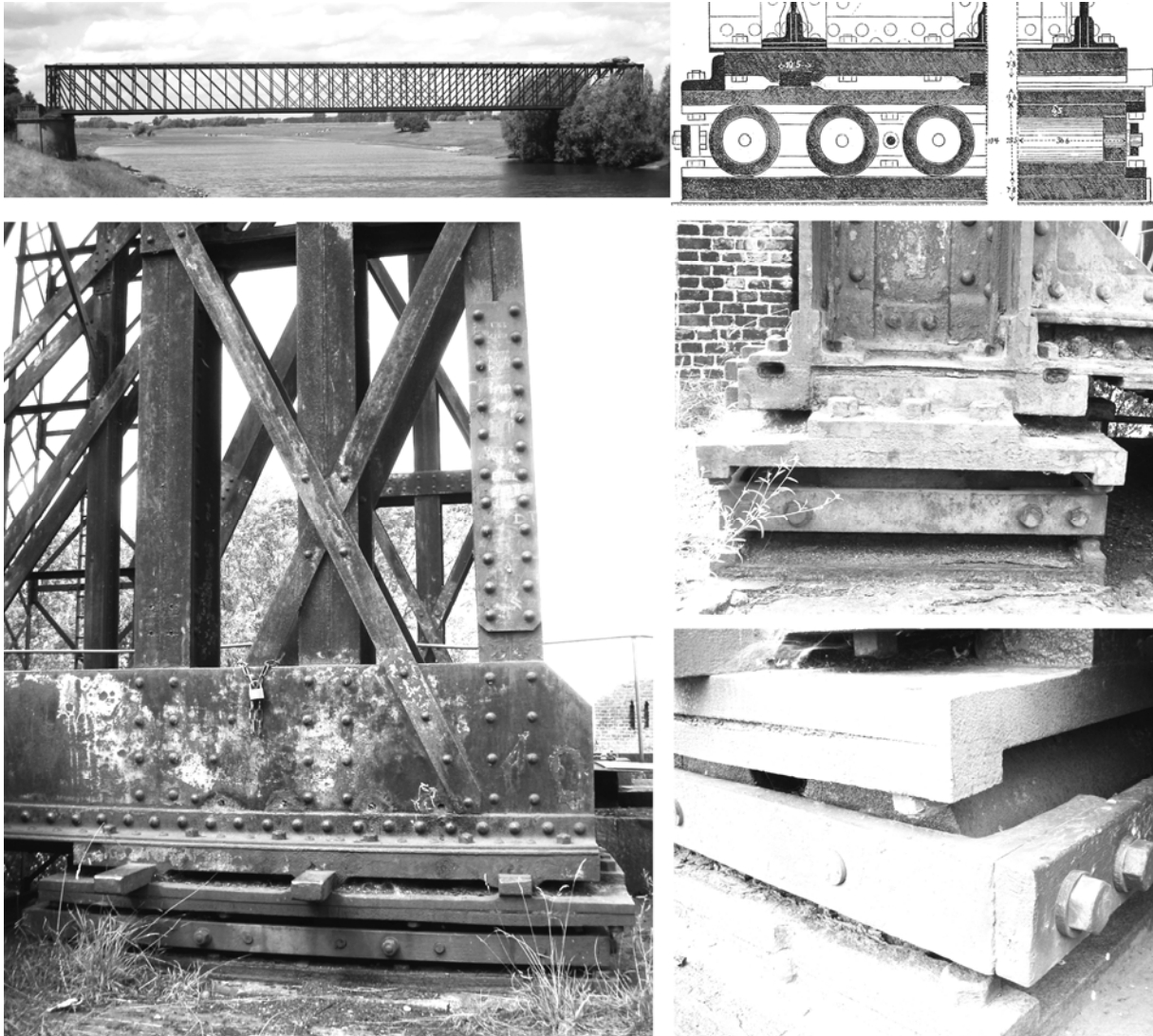
Abb. 79: Brücke über den Alten Rhein bei Griethausen; Oben: Links: Ansicht [ 670], Rechts: Bewegliches Lager - Schnitt [ 108]; Unten: Links: Auflagerpunkt des Überbaus am beweglichen Lager, Rechts: Blick auf die „Stirn“-Seite des Auflagerpunkts (oben) sowie Blick in den Walzensatz (unten); Aufnahmen 2009; [ 670]
