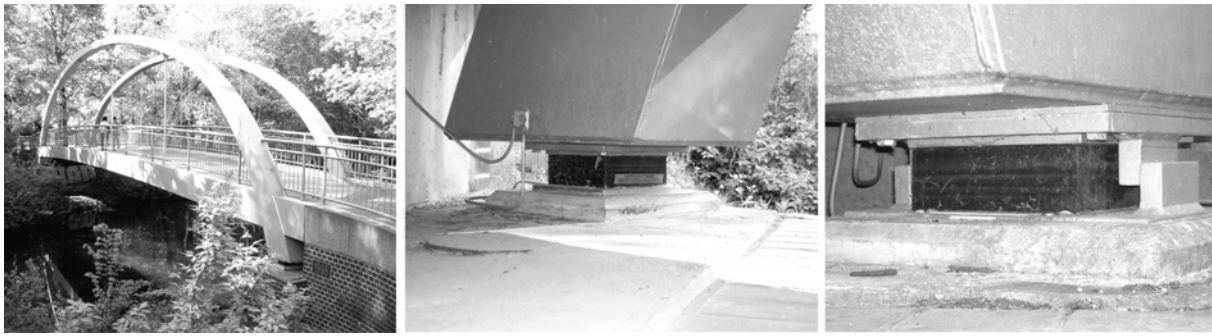
Abb. 30: Bogen-Zugband-Brücke im Cottbuser Goethepark; Diese kleine Brücke von 1998 bietet im Gegensatz zu vielen ähnlichen Brücken großer Spannweite eine sehr gute Zugänglichkeit zu den Lagern. Links: Ansicht, Mitte: allseitig bewegliches Verformungslager, Rechts: Verformungslager mit Queranschlag; [ 670]
