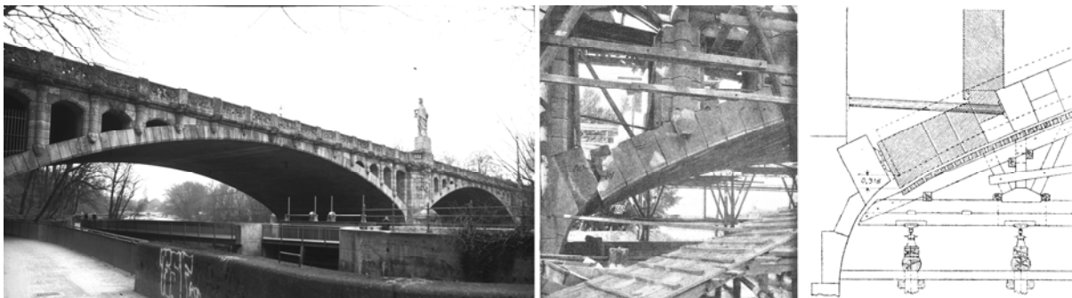
Abb. 41: Maximiliansbrücke München; Links Ansicht [ 686], Mitte/Rechts: Abgerutschtes Lager – Ansicht [ 136] und Skizze [ 547]
