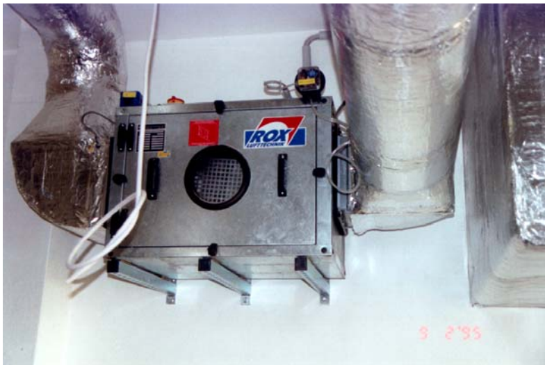
Abb. 9: Fassadenabluftventilator – Anschluß zur Lüftungstechnischen Anlage des Gebäudes.
