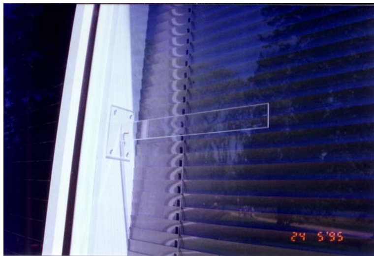
Abb. 14: Beispiel für die Installation eines Mantelthermoelementes im Fensterkastenbereich.
