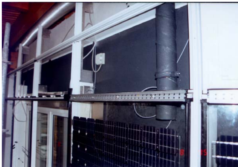
Abb. 8: Abluftkanal - Vertikalschacht oben mit Übergang in den Sammelkanal und Fassadentemperaturfühler.
