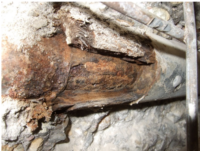
Abb. 5: Korrosionserscheinung an einer Spanngliedkopplung mit Übergangsstücken aus Holz in 2010
