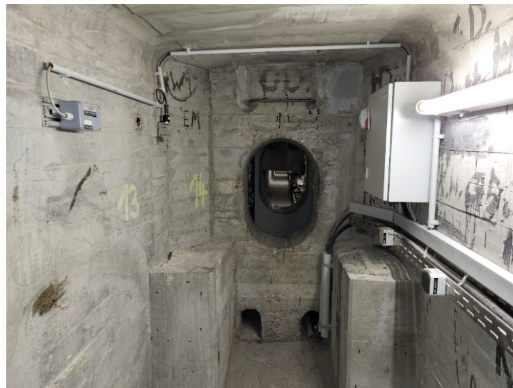
Abb. 9: Teile der Monitoringanlage im Inneren des Hohlkastens, links: Neigungs- und Beschleunigungssensoren, rechts: Messschrank. Quelle: MKP GmbH
