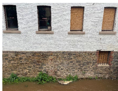
Abb. 70: Beim Hochwasser in Bad Münstereifel dienen Kellerräume als Retentionsvolumen (cK)
