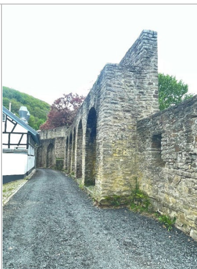
Abb. 31: Historische Stadtmauer blockierte Wasser beim Hochwasserereignis 2021 (cK)
