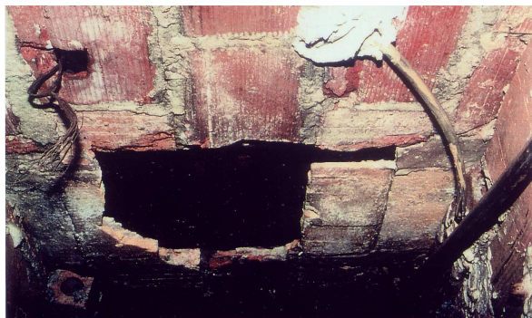
Abb. 3-4: mit Ziegelschalen (teilweise abgefallen) verkleideter I-Träger
