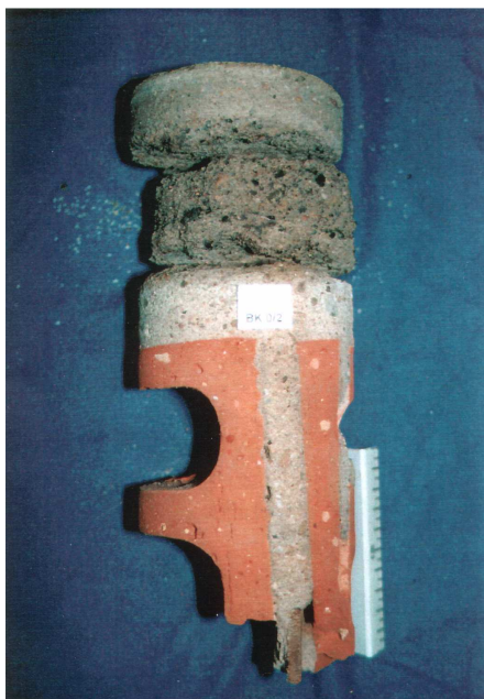
Abb. 10-1: Mörtelfehlstellen im Bereich der Bandeisenbewehrung
