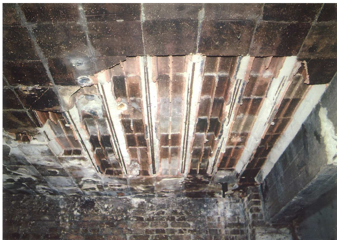
Abb. 10-3: abgesprengte untere Ziegelschalen an einer Kellerdecke
