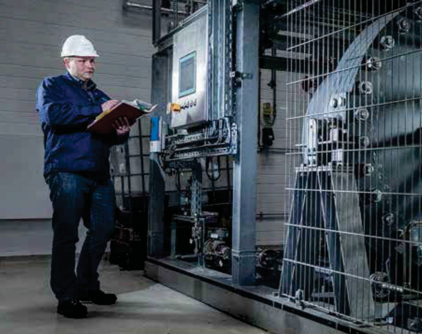
Robert Guder, wissenschaftlicher Mitarbeiter am Lehrstuhl Kraftwerkstechnik, überwacht die Nutzung von überschüssiger Windenergie zur Herstellung von Wasserstoff.
