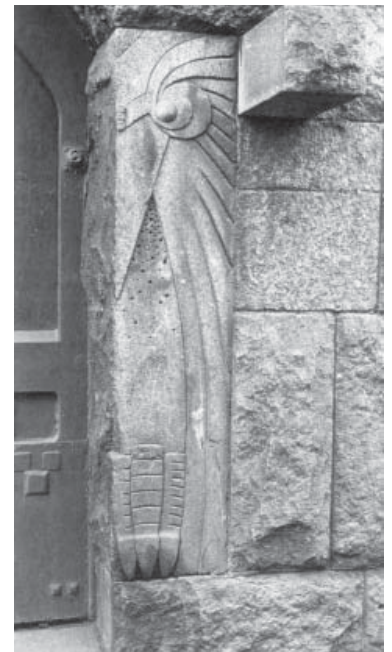
Architekt A. Bubir, eigenes Mietshaus in Stremiannaja Str. 11, 1906-1907 Detail des Eingangsportals, stilisierter Vogel in: Kirikov, 2008, S. 404
