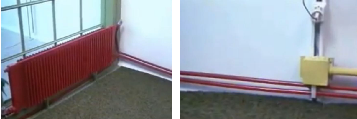
Abb. 4.4.5-10 und Abb. 4.4.5-11 Installationen sind auf Putz eingebaut, was sie sichtbar macht (Rohre, Schaltdosen) und dem Raum einen technischen Anstrich verleihen.
