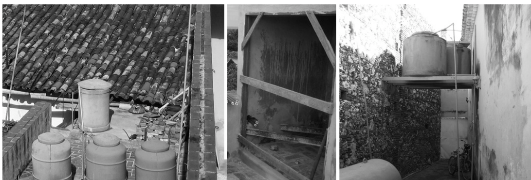
Abbildung 38: Wassertanks auf Dachterrassen, in Dachaufbauten und zwischen Gebäuden
