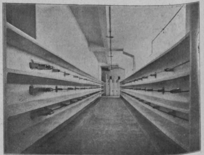
Abb. 67 20.000-Volt-Sammelschienen in Betonzellen
