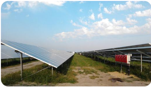
Abbildung 4 Position der Wechselrichter zwischen den PV-Modulreihen in der Pilotanlage.
