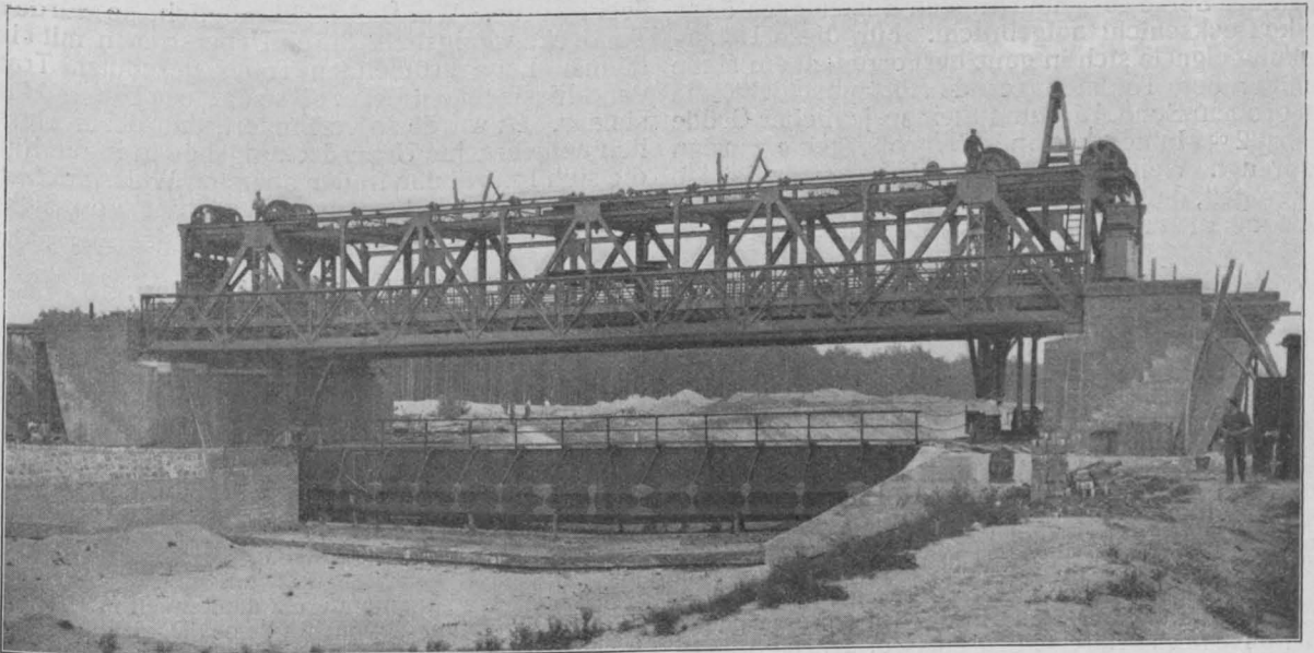
Abbildung 14. Traggerüst einer Kanalbrücke mit Sicherheitstor in der Verschlussstellung.
