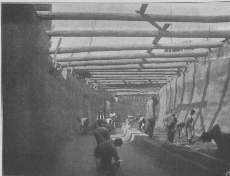
Abbildg. 10. Fertigstellung der Sohle mit Entwässerungsrinne. Die Erweiterung der Berliner Untergrundbahn nach dem Westen.
