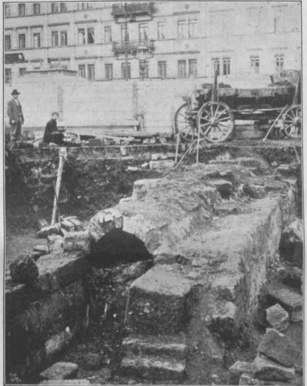
Abbildg. 4. Alter Kaitzbach-Kanal. Durch Ablagerungen zum größeren Teile ausgefüllt.
