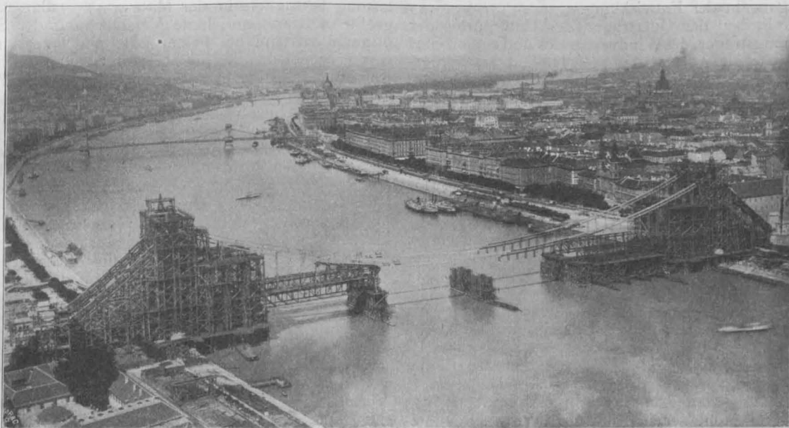
Abbildg. 22. Die Elisabeth-Brücke während der Montage. Abbau der Stromrüstungen nach Einbau der Ketten. (Photographische Aufnahme von Antal Weinwurm in Budapest.)
