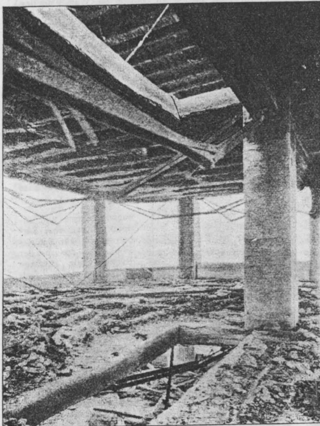
Fig. 3. Ansicht der beiden obersten Geschosse von unten (nach dem Brande).
