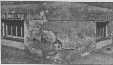
Zerstörung von Beton bei Verwendung metallhaltiger Zuschlagstoffe.
