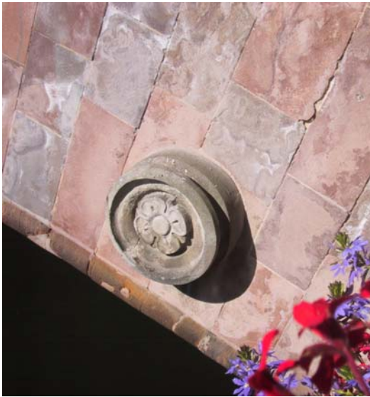
Abb. IV-98: Ansicht Oberstromseite mit starken Versalzungen. Juli 2001. Foto C. Kaiser
