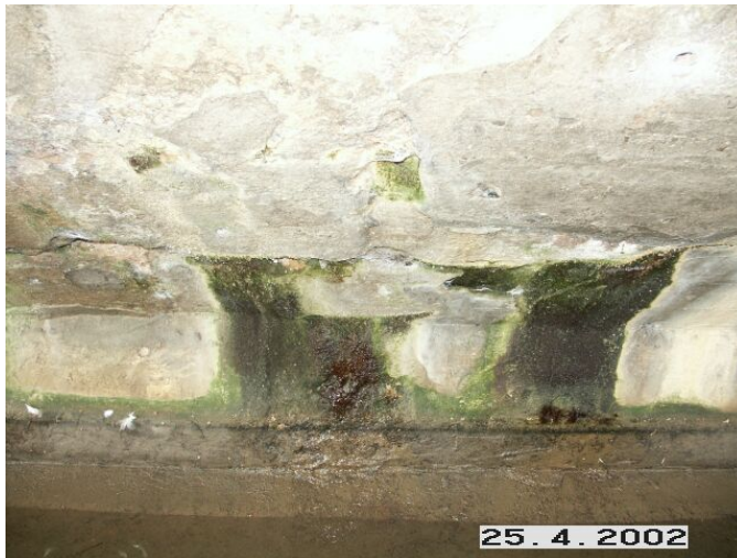
Abb. IV-101: Spuren des Wasseraustritts am nördlichen Kämpfer. 25.4.2002. Fotos Kaiser
