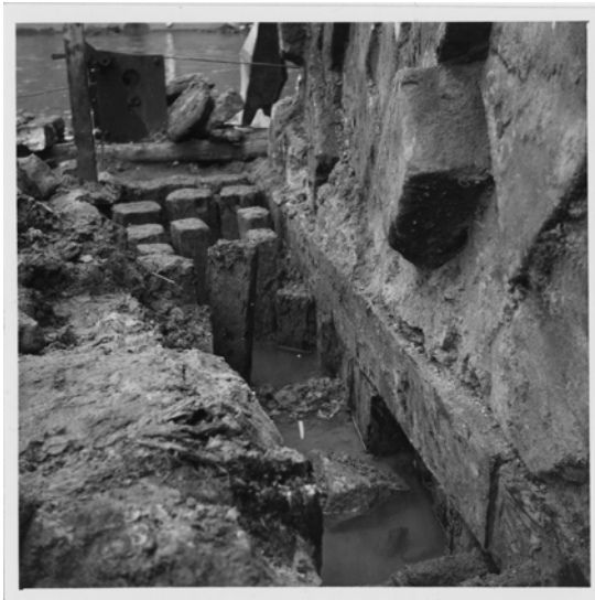
Abb. IV-37: Fleischbrücke Widerlager Süd/West. Sichtbar die Pfähle der mehrreihigen Spundwand und die tiefer endenden Pfähle unter dem horizontalen Rost, Nut und Feder hier nicht erkennbar, 13.1.1956. Foto R. Funk (vgl. Bd. 3, Foto 36)
