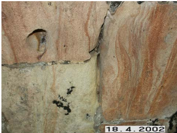
Abb. IV-90: In der Untersicht sichtbare Schichtung der Sandsteine parallel zur hier ausgewaschenen Lagerfuge, schmale Stoßfuge erkennbar. 18.4.2002. Foto C. Kaiser
