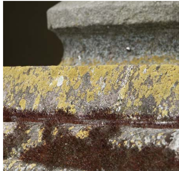
Abb. IV-99: Moosbewuchs an den Gesimsen. 8.6.2003. Foto C. Kaiser
