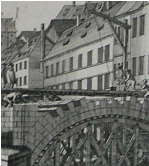
Abb. IV-92: Baustelle der Karlsbrücke in Nürnberg 1728. Ausschnitt aus Abb. No. 41 in Schramm (1735). Gesamtgröße ca. 32 x 23 cm. Als Einzelblatt in GNM: SP 13305
