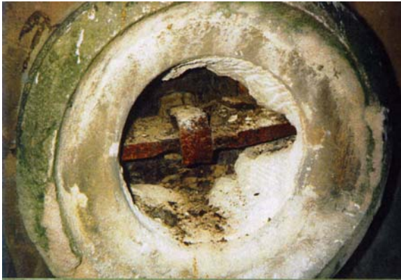
Abb. IV-94: Verrostete Schlauder Oberstrom, 2. von links in Fließrichtung bei Sanierungsarbeiten der Embleme. In Tiefbauamt Nürnberg
