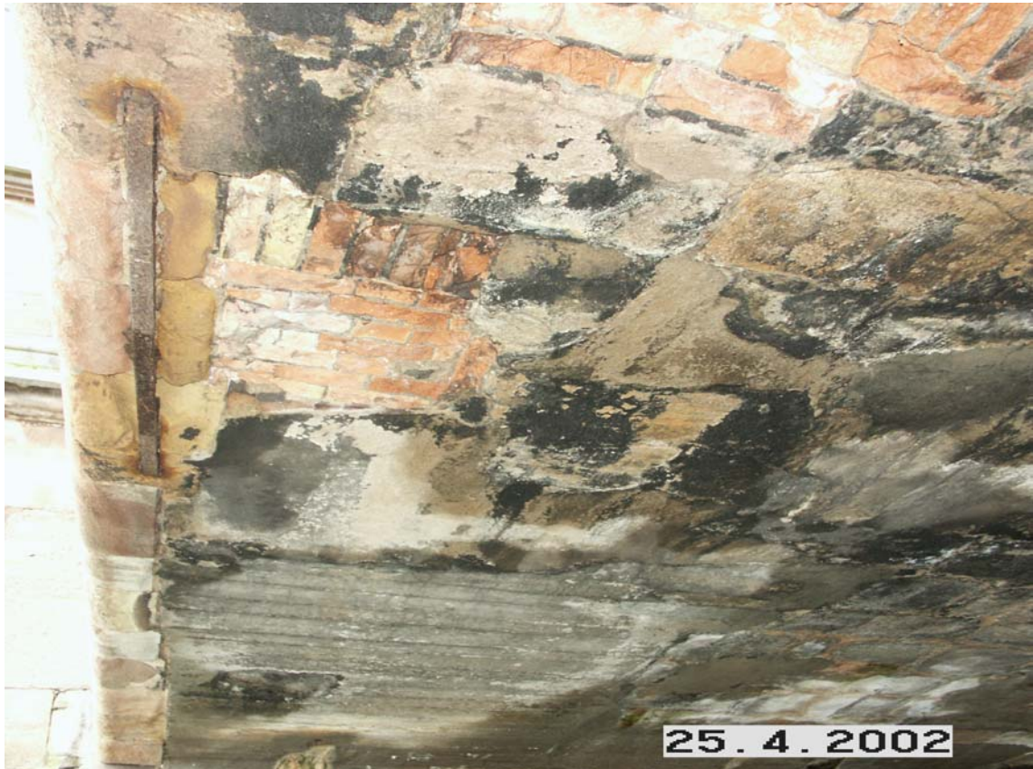
Abb. IV-100: Untersicht Westseite, Unterstrom, unterschiedlichste Plomben aus Mauerwerk und Beton, Eisenanker. Foto C. Kaiser, 25.4.2002 (vgl. Bd. 3, Foto 58)
