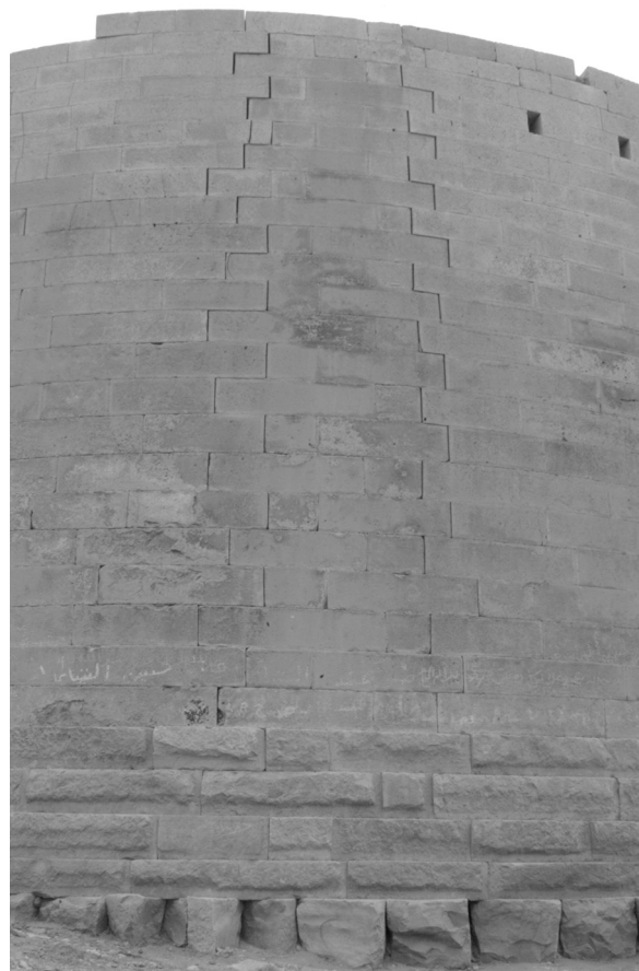
d. Klaffende Fugen entlang der Binderpaare an der Krümmung im Südostbereich der Umfassungsmauer
