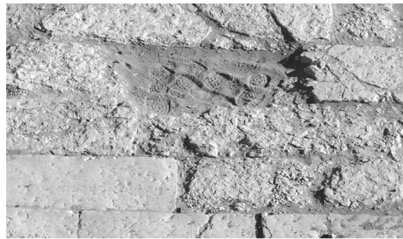
d. Teilweise stark beschädigter Plattenbelag durch Abschalen des Materials
