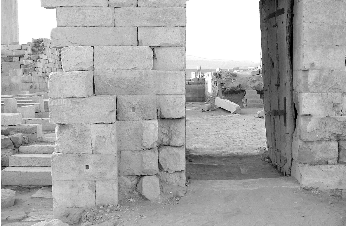
a. nördliche Torlaibung des Zugangs Z1 links im Bild, Z2 rechts im Bild
