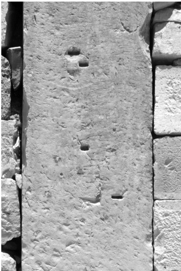
c. Inneres Propylon, Westansicht des vierten Pfeilers von Norden mit Schleifspuren
