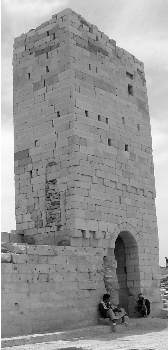
a. Vertikale Rissbildung an der Ostfassade des rezenten Wohnturms
