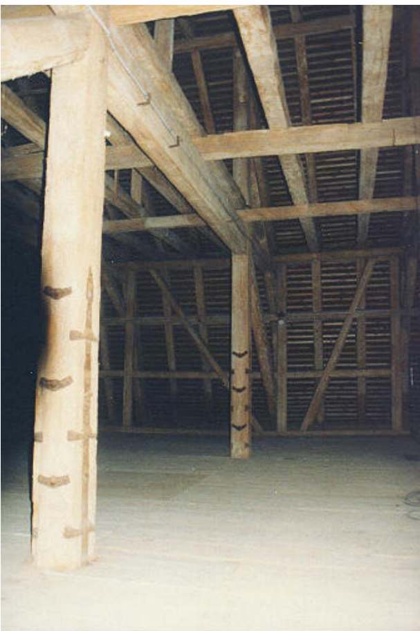
Foto 13 Stadthalle Zerbst – Korrodierte Flachstähle an den Hängesäulen
