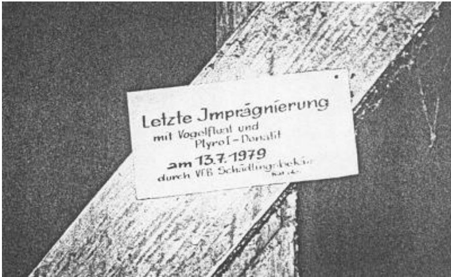
Foto 5 Stadthalle Zerbst – Tafel mit Angaben zur Holzschutz- und Holzflammschutz-Mittelbehandlung
