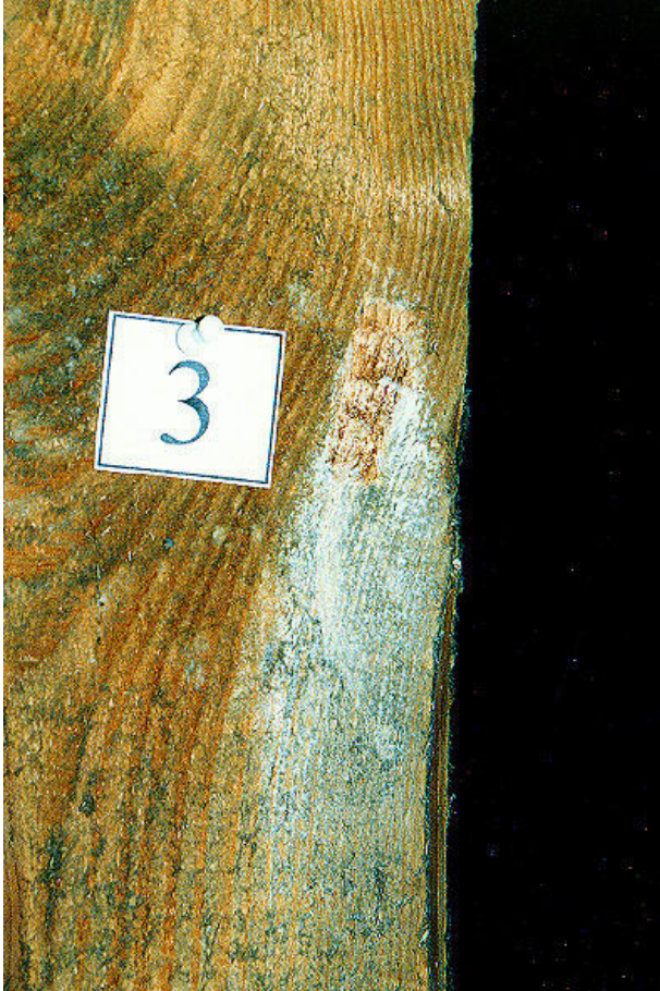
Bild 0.2 Salzausblühung an einer durch chemische Korrosion geschädigten Stuhlsäule
