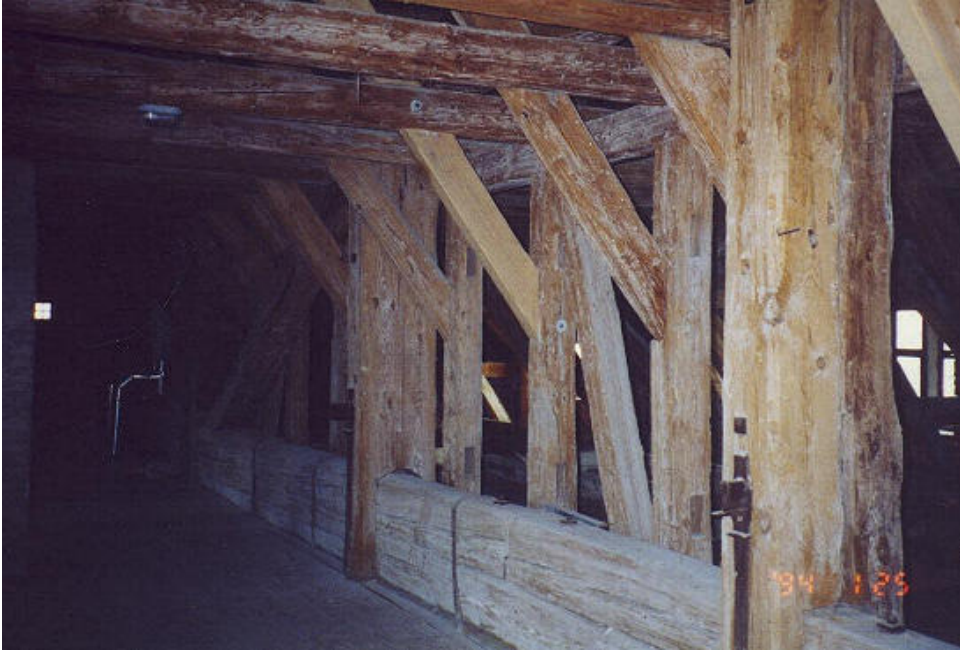
Foto 14 Lutherhalle Wittenberg – Korrodierte Flachstähe an den Hängesäulen
