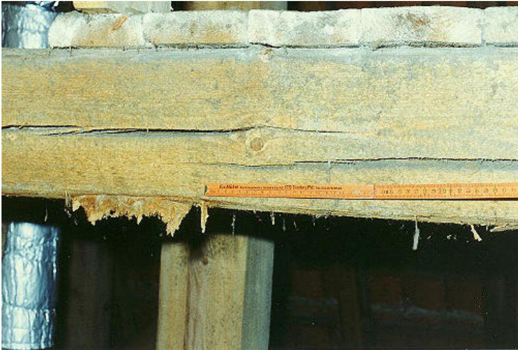
Foto 10 Herabhängende vorhangähnliche Faserbündel
