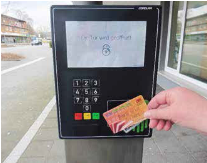
Abb. 1: Card Reader als technische Zugangskontrolle vor dem Gebäude. © Stadtbibliothek Bielefeld.
