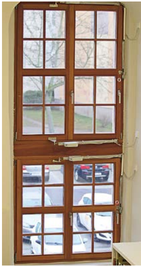
Mehr als 40 der Doppelfenster wurden mit Motoren ausgestattet, welche die Fenster im Brandfall in wenigen Sekunden öffnen.
