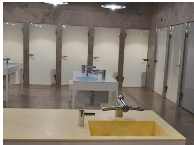
Im Untergeschoss findet sich eine Unisex-Toilettenwelt – mit pastellfarbenen Porzellaninstallationen aus einer finnischen Sonderanfertigung.
