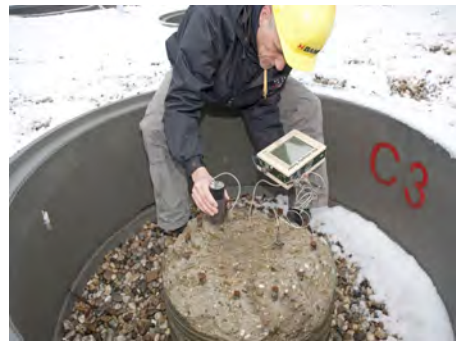
Abbildung 9.1. Oben: Pfahlintegritätsprüfung auf dem BAM-TTS in Horstwalde. Links: Prinzip der Pfahlintegritätsprüfung nach der Hammerschlagmethode.
