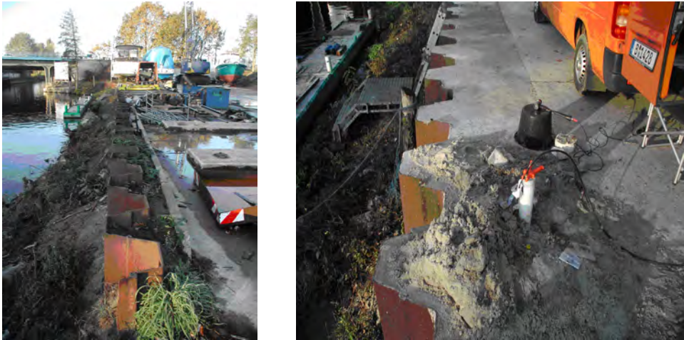
Abbildung E.1: Spundwand auf dem Gelände der Firma Hollandboot. Links: Übersicht. Rechts: Detail mit Bohrloch und Parallel-Seismik-Sensorkabel
