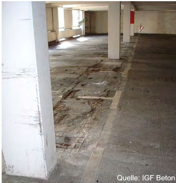
Abbildung 2-3 Parkdeckoberfläche mit offenen Schäden durch Korrosion der Bewehrung.
