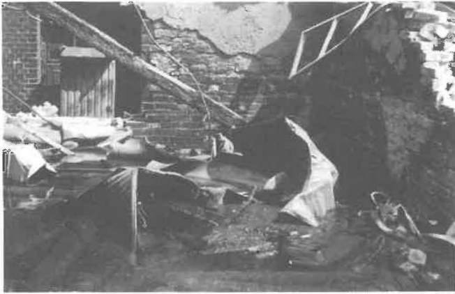
Bild 1 Durch Explosionsvorgänge bewirkte Zerstörung eines Flaschenbatterieraumes mit folgenden Ausmaßen:
