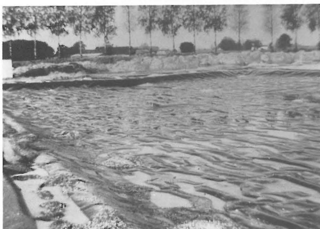
Abb. 5 Regenpfützen auf Kunststoffabdichtungsbahn
