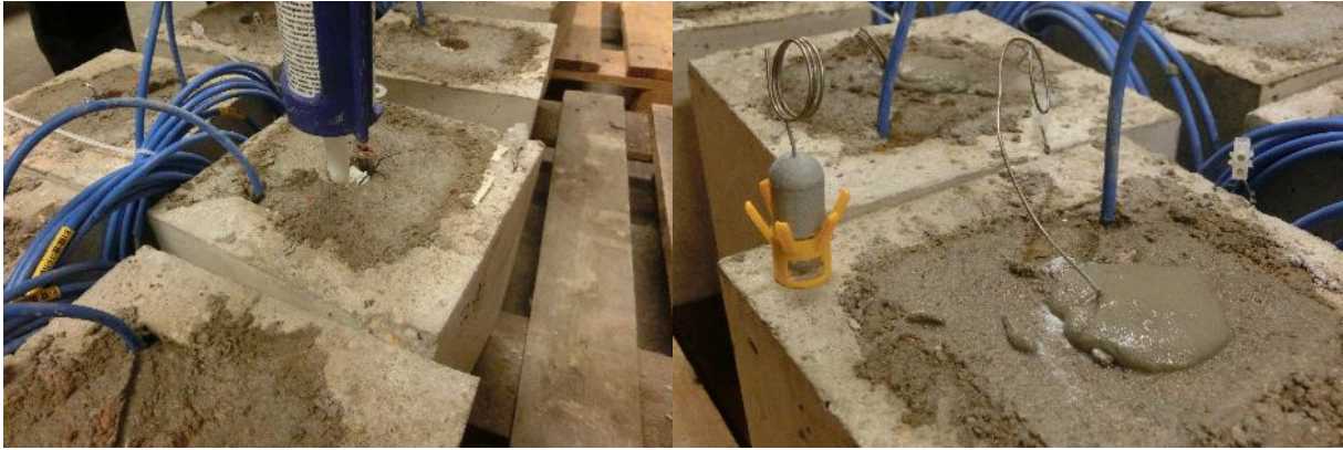
Abb. 15: Einbau der Serien B2 und B3, Einbringung Einbettmaterial (links) und nach Verschluss (rechts)
