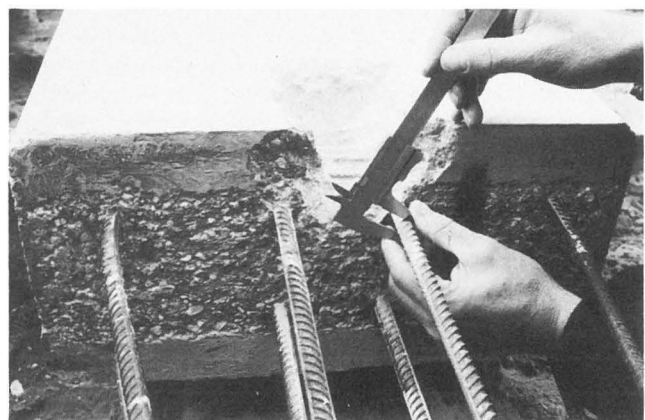
Abb. 5 Feststellung der Stabdurchmesser und Entnahme von Stahlproben an Bewehrungspositionen mit Überlänge zur Ermittlung der Betonstahleigenschaften
