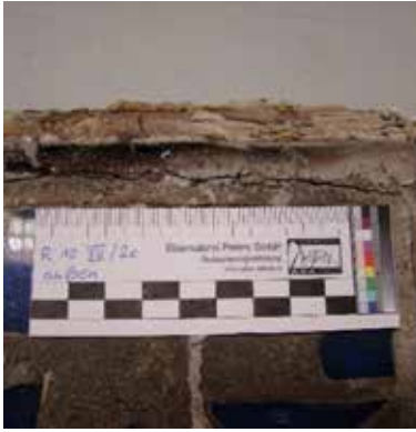
Abb. 8a: Photographische Dokumentation des Zustandes des jeweiligen Fensterelements von der Innen- und Außenseite mit Markierung sichtbarer Schäden.
