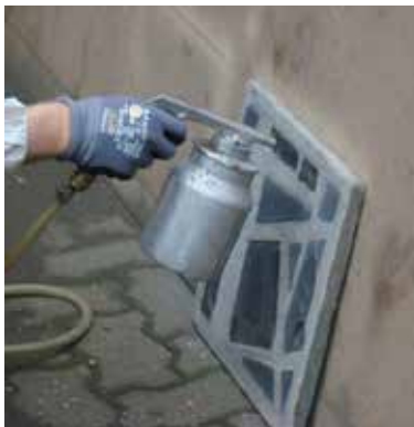
Abb. 8d: Die im Bereich der Risse oder anderen Schadstellen freiliegende Bewehrung wird durch Sandstrahlen von eventuellen Korrosionsprodukten befreit.
