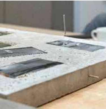
Abb. 8f: Zwei Stahldrähte werden mit der Stahlbewehrung verbunden, um eine elektrisch leitfähige Verbindung für die spätere Realkalisierung zu ermöglichen.
