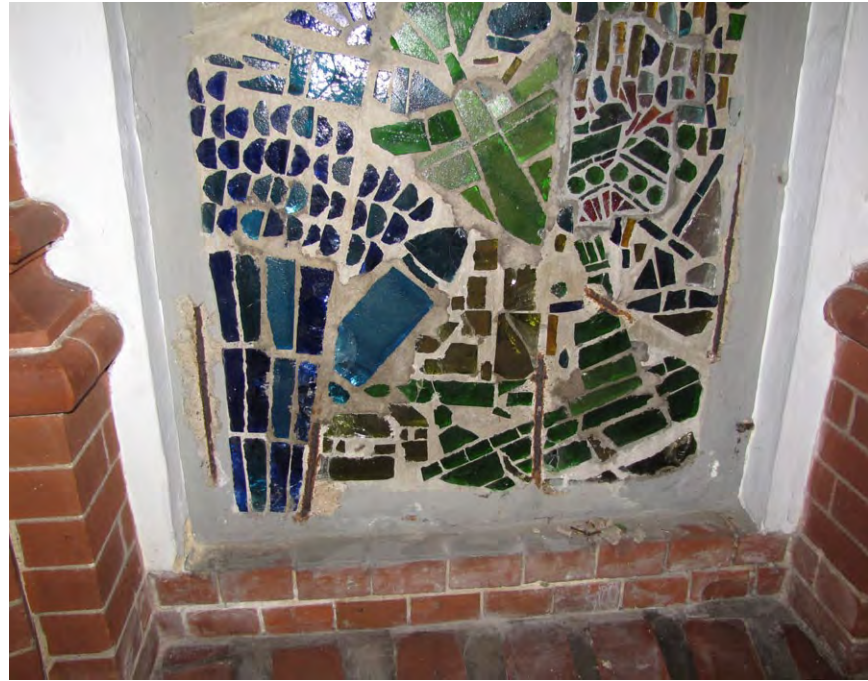
Heilig-Kreuz-Kirche Frankfurt/Oder – Betonglasfenster mit Bewehrungskorrosion, Betonabplatzungen und Glasbrüchen Holy Cross Church Frankfurt / Oder – “Dalle de Verre” with reinforcement corrosion, concrete spalling and broken glass
