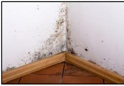
Wand mit Schimmelpilzbefall 1
