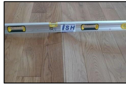
Quellen durch Feuchte im Holzdielenboden 2
