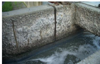
Betonkorrosion Sulfat-Angriff [\text{SO}_4]^{2-}
