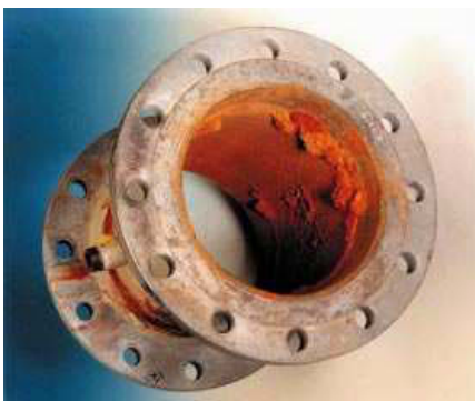
Abb. VII.3-1 Schaden durch Messerlinienkorrosion an einer Hartlotverbindung
