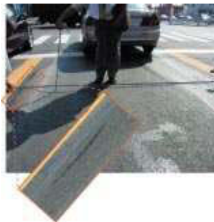
Abb. VII.1-2 Spurrinnenbildung und Längsrisse in einer Straßenbefestigung mit einem Fahrbahnbelag aus Asphalt
