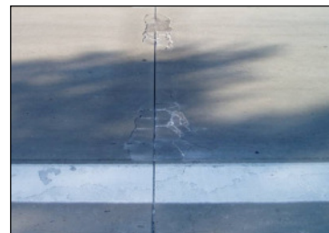
SK III: + Ausbrüche
