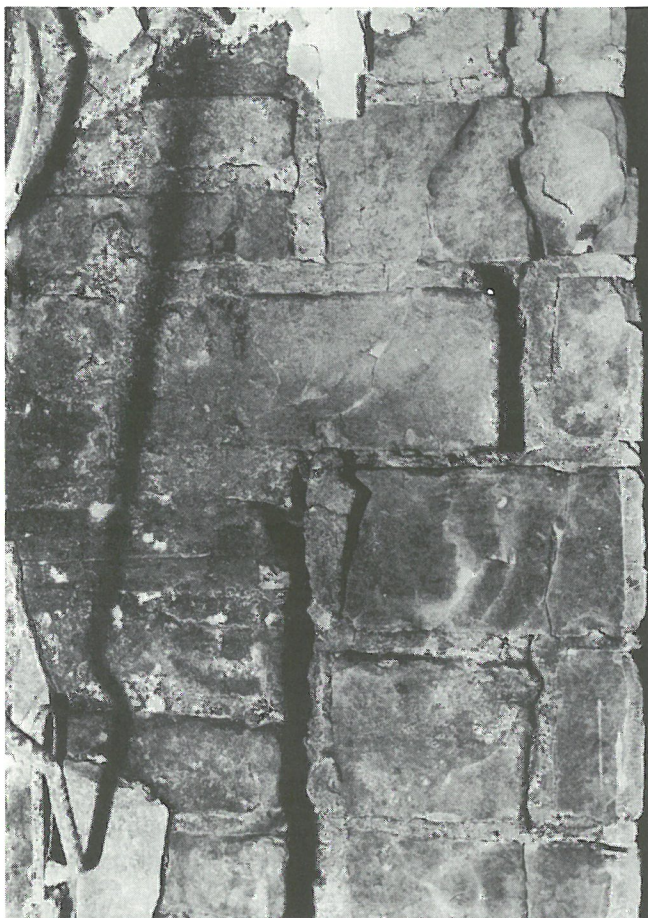
Bild 35 Mauerwerkspfeiler nach Brandeinwirkung in einem natürlichen Brand Foto: Berliner Feuerwehr
