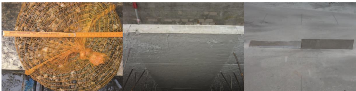
Abbildung 20: Kiesnest, glatte Rückwand und verzinktes Fugenblech in Wand B
