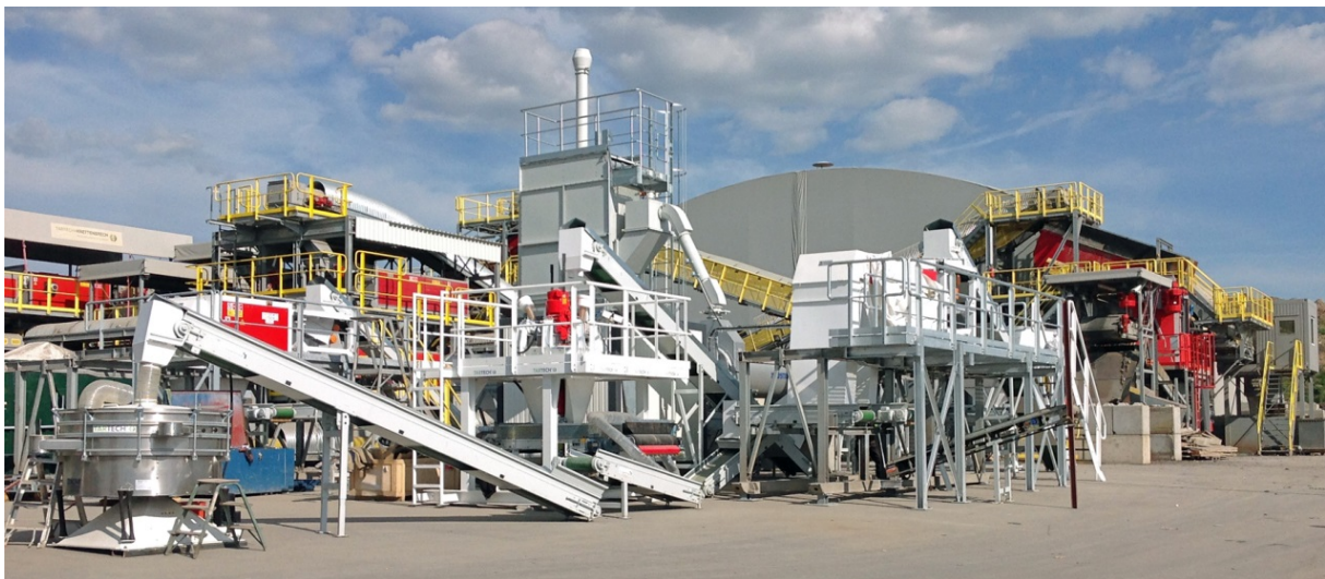
Abb. 1: Ansicht der Aufbereitungsanlage für Hausmüllverbrennungsrückstände (HMVA) in Wiesbaden: Alpha-Linie im Hintergrund, Beta-Linie (weiß) im Vordergrund.
