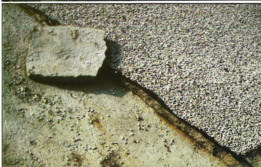
Bild 15: Bruchstelle von Spannglied IX 2 an der Ringbalkenfuge, stark korrodierte Bruchflchen der Spanndrhte erkennbar, die auf lnger zurckliegende Brche hinweisen
