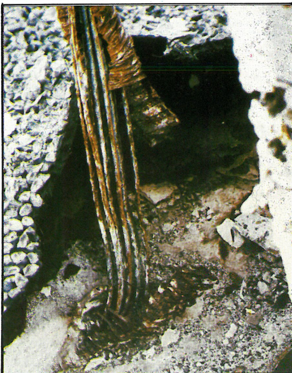
Bild 25: Abbruchkante am Ringbalken im Bereich des Spanngliedes XXIV 2, starke Anrostungen der Spanndrähte und des Hüllrohres
