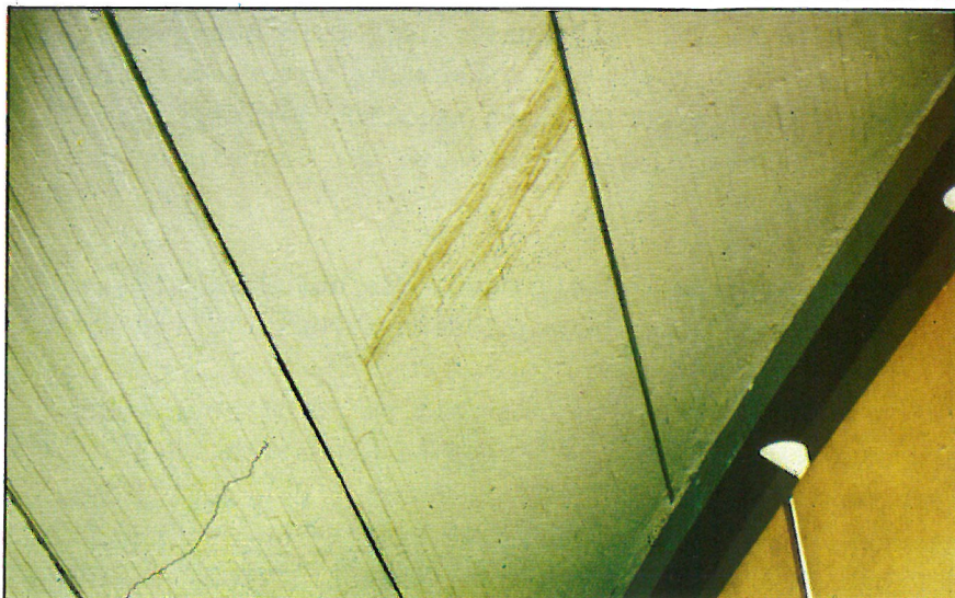
Bild 33: Dachplatten des nördli- chen Außendachbereiches. Ablaufspuren einer bräunlichen Flüssigkeit. Flüssigkeitsaustritt an den Plattenfugen
