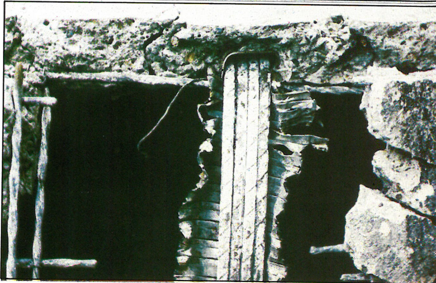
Bild 27: Unverpreßter Spannglied VII 2 im Plattenfeld. Spanndrähte und Innenfläche des Hüllrohres nicht korrodiert
