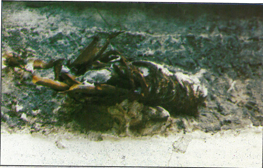
Bild 26: Bruchstelle des Spanngliedes II 3 am Bogen, Hüllrohr bis in den Plattenbeton hinein stark korrodiert, duktile Spanndrahtbrüche, Beton unterhalb des Hüllrohres vollständig carbonatisiert, Oberfläche der Arbeitsfuge zwischen Bogen und Platte neben dem Hüllrohr stark verschmutzt
