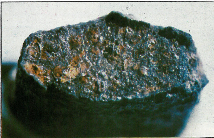
Bild 24: Stark angerosteter al- ter Bruch eines Spann- drahtes aus dem Spann- glied VIII 3
