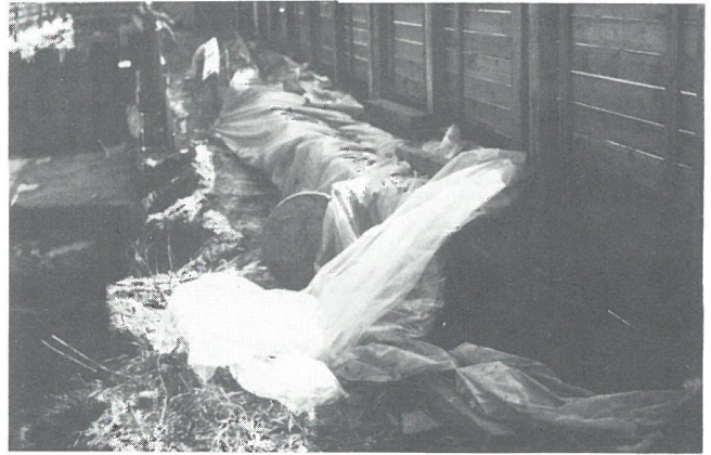
Abb. 23 Ungünstige Lagerung von Spannstählen auf der Baustelle
