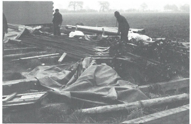
Abb. 17 Ungünstige Lagerung von Spanngliedern (SUSPA) auf der Baustelle
