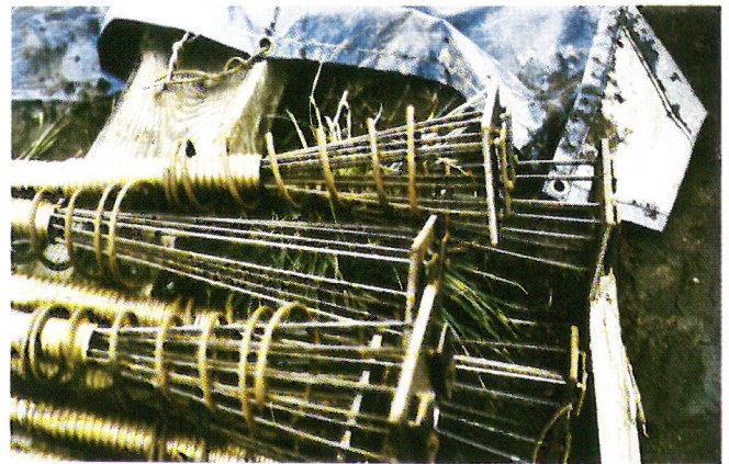
Abb. 18 Punktförmiger Korrosionsangriff durch Kondenswasser an Spannglied- enden
