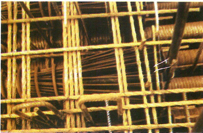
Abb. 28 Flächige Korrosion an freiliegenden Spanngliedenden (Festanker)
