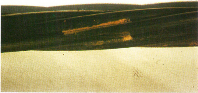
Abb. 20 Korrosion im Zwickelbereich von Litzen
