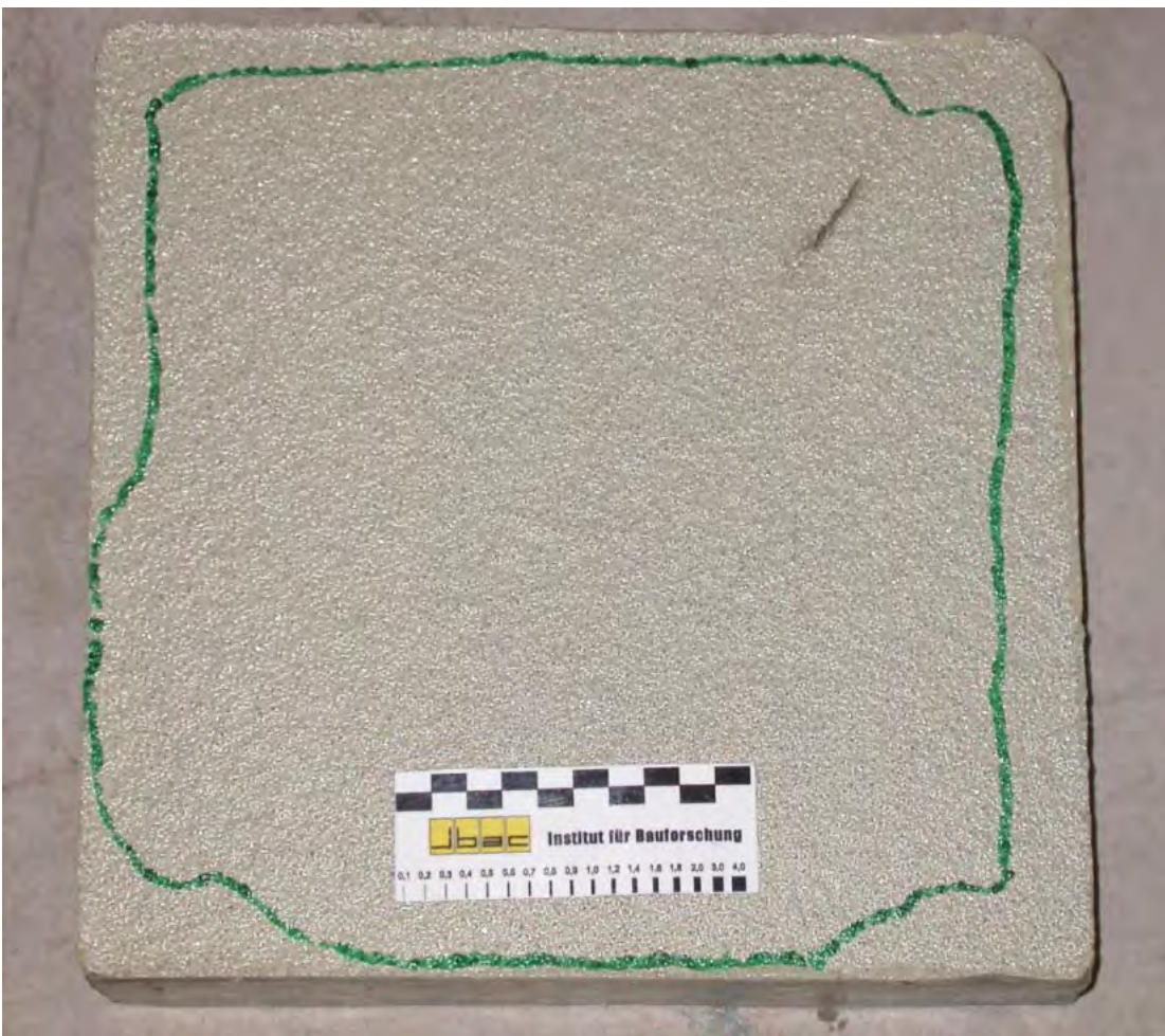
Bild 4.2-14: Blasenbildung mit großflächiger Enthftung bei den mit OS 13 beschichteten Betonplatten nach künstlicher Bewitterung
